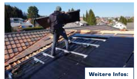
Bild 11: Fast geschafft: Die letzten Module komplettieren die Anlage.
